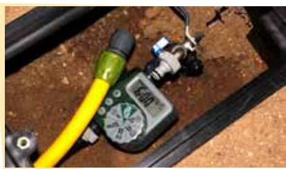
Arqueta con programador y manguera
